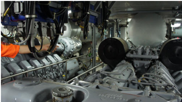
巡邏艦底層輪機室。
